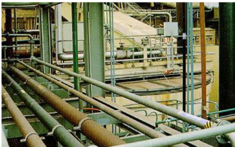
Рисунок 4. Стеклопластиковый трубопровод для серной кислоты
